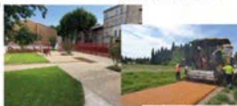
Aménagement du Parc Solaire Pierrelatte
